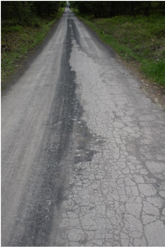
Asfaltowa droga leśna po kilku latach eksploatacji - popękana, pozapadana, z głębokimi koleinami, nieudolnie naprawiana żwirem.
